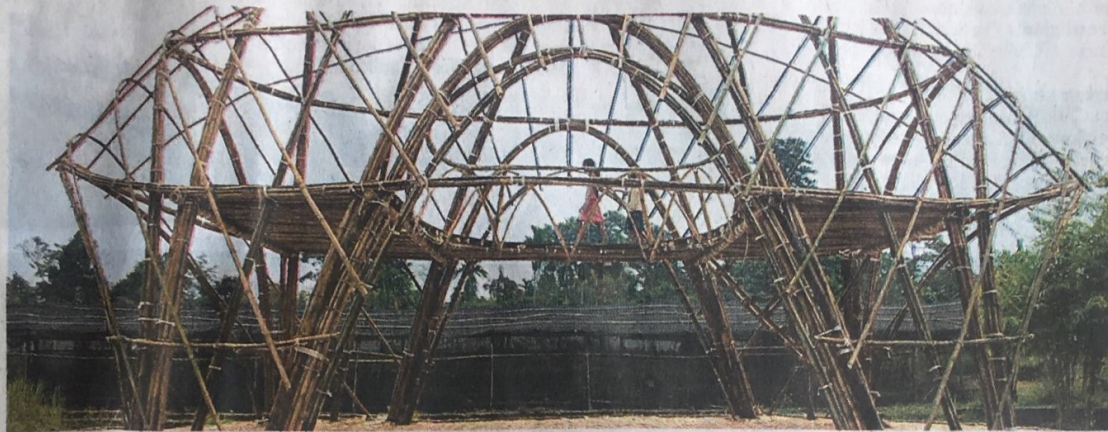
Les habitants seront formés à la réalisation de structures en bambous par Fatima Martin.
